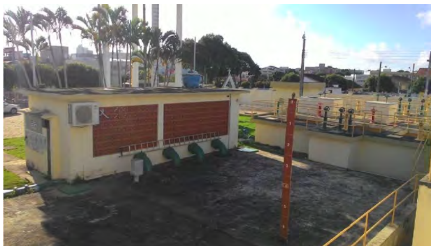
Figura 6.1.1-4: Casa de bombas subsistema Aracruz-Sede.
