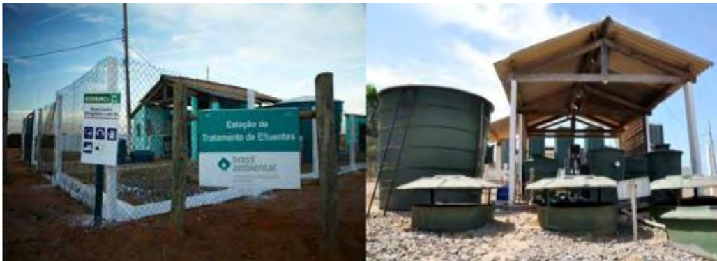
Figura 8.5.1.1-9: Estação de Tratamento de Efluentes – ETE.
