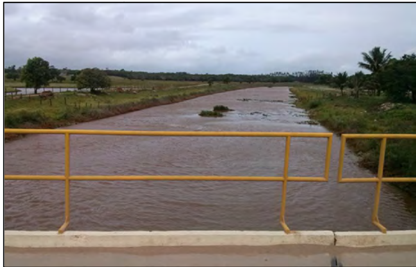
Figura 9.4-10: Assoreamento do Rio Riacho próximo à ponte. Fonte: foto própria.
