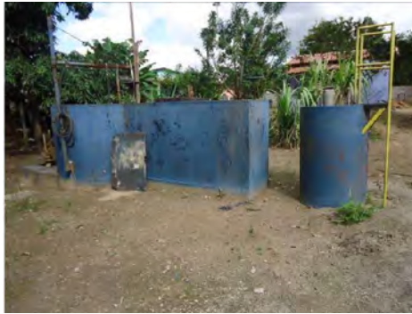
(a) Elevatória de esgoto
