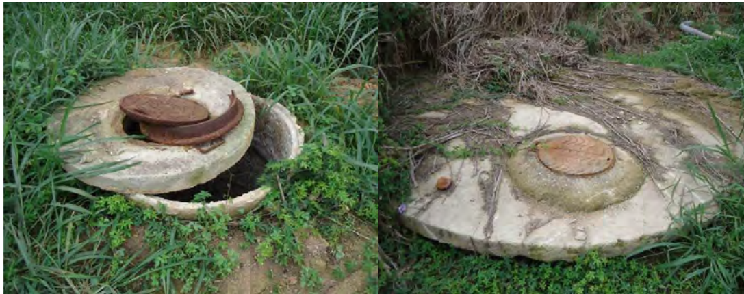
(a) Poço de visita entrada do esgoto
