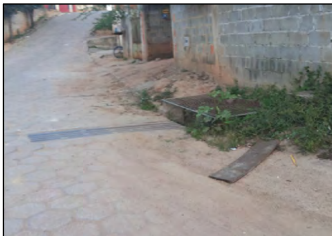
Figura 9.8.1.1-13: Grelha posicionada na Rua Túlio dos Santos Pereira. Fonte: Foto própria.
