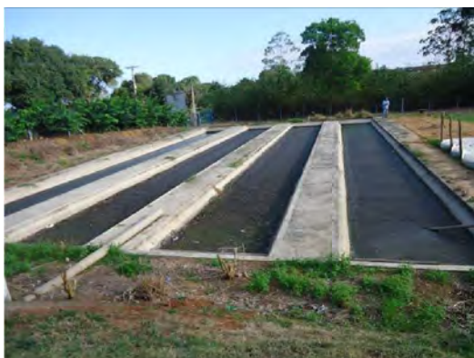
(a) Valo de oxidação
