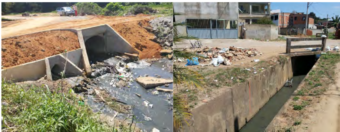
Figura 9.3-1: Acúmulo de resíduos no final da canalização do Córrego Morobá no Bairro São Clemente (a) e no Bairro Segatto (b) da cidade de Aracruz. Fonte: fotos próprias.
