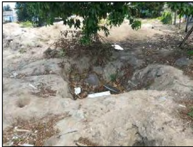
Figura 9.8.5-4: Marcas da última desobstrução feita pelos moradores. Fonte: Foto própria.
