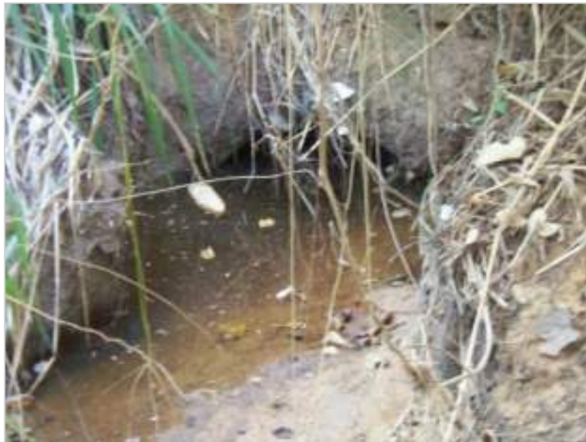
Figura 23 - Acúmulo de água em manilha localizada próxima das coordenadas 367159 E / 7805101 N.
