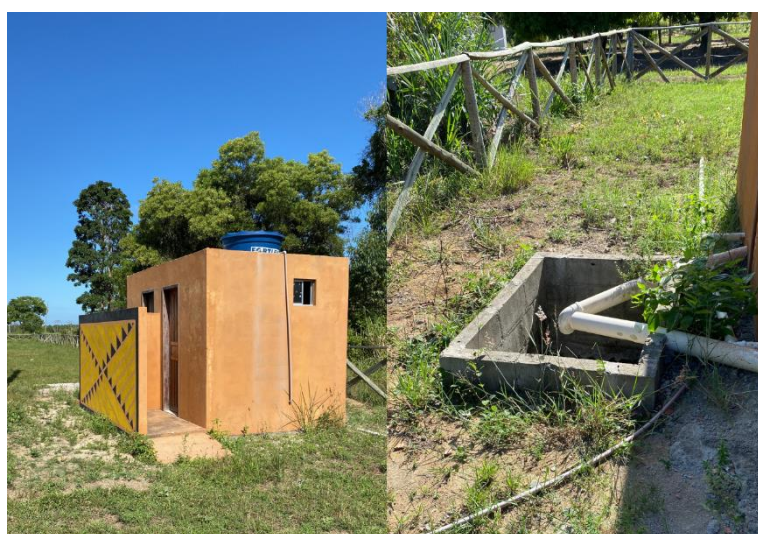
Figura 7-5: Banheiro com fossa, Aldeia Olho D'água.
