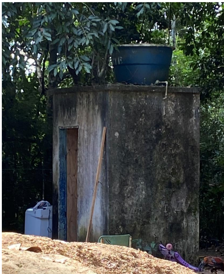
Figura 7-2: Condições dos banheiros, Aldeia Boa Esperança
