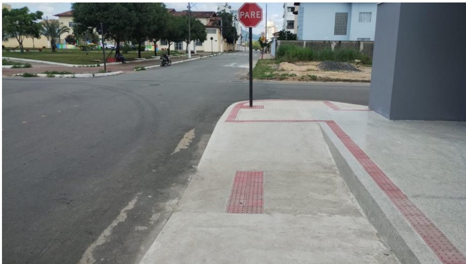
Figura 92: Cruzamento da Rua Leopoldo b. Rangel com a Rua Flor de Lotus: calçadas irregulares e sem continuidade. Ausência de faixa de travessia de pedestres Fonte: Regini, Marcelo. Novembro, 2025.
