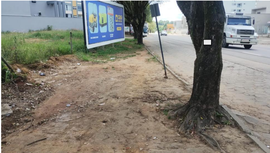
Figura 91: ES-257, próximo ao ponto de ônibus, sentido Rua Flor de Maio: calçadas não construídas. Fonte: Regini, Marcelo. Novembro, 2025.
