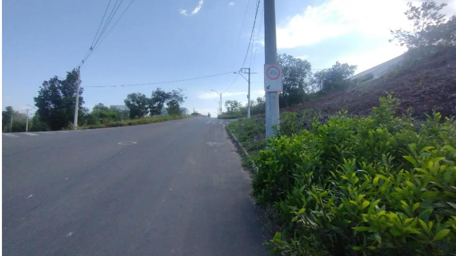
Figura 15: Rua Flor de Maio: sinalização de ciclovia e ciclovia apagada Fonte: Regini, Marcelo. Novembro, 2025.
