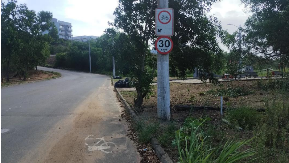
Figura 77: Rua Flor de Maio: sinalização de velocidade e ciclovia com pintura desgastada Fonte: Regini, Marcelo. Novembro, 2025.
