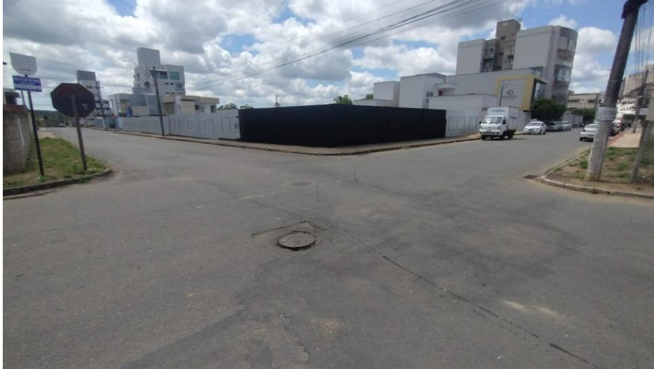
Figura 97: Cruzamento entre a Rua Flor de Maio e a Rua Leopoldo B. Rangel: ausência de rampas nas esquinas e de faixa de travessia de pedestres Fonte: Regini, Marcelo. Novembro, 2025.
