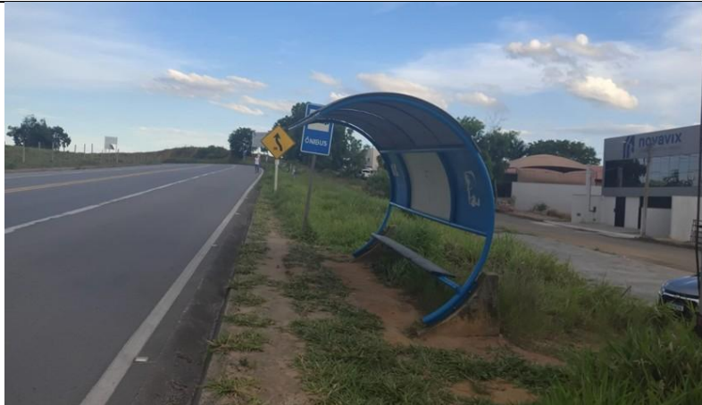
Figura 9: Ponto de parada de ônibus – Sentido Fábrica – Observa-se falta de pavimento da calçada
