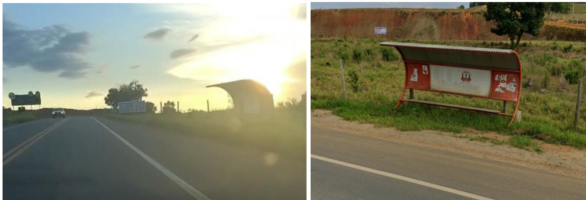
Figura 10: Ponto de parada de ônibus – Sentido Prefeitura – Observa-se falta de pavimento da calçada
