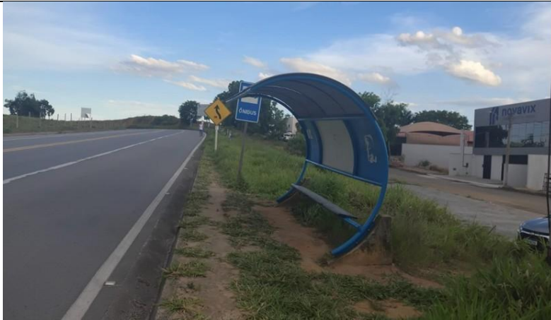
Figura 24: Ponto de parada de ônibus – Sentido Fábrica – Observa-se falta de pavimento da calçada. Fonte: Autor: Março 2026
